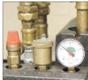
(pb) Richtig eingestellt spart die Heizung Energie und Geld.
